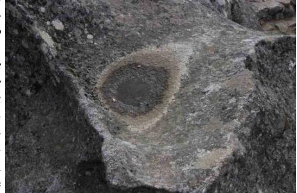
Una vaschetta di corrosione allo stato embrionale. Come si può vedere l’evaporazione dell’acqua ha determinato la deposizione di sali e la successiva desquamazione del granito (area di “Piscia di u Ghjaddicu”).
