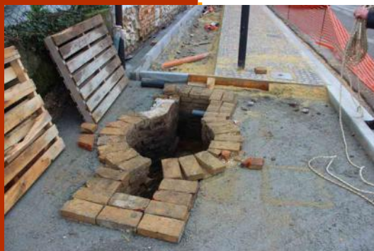
Il pozzo venuto alla luce durante i lavori di riqualificazione della via Lauretana a Versa.
