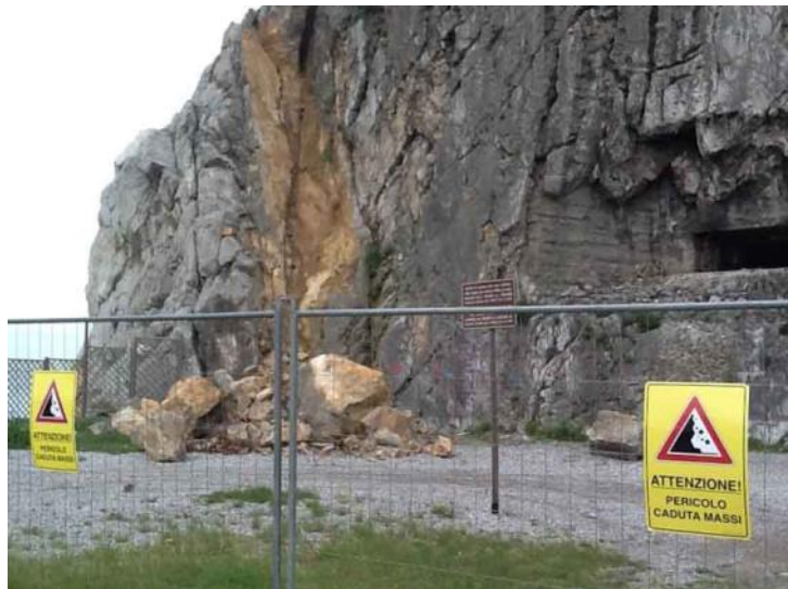
Sistiana (TS). Il crollo avvenuto sulla parete dove i climbers nostrani si esibivano nelle loro arrampicate.
