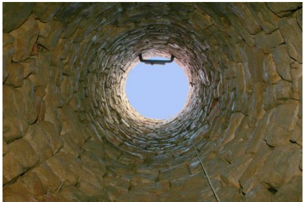
Il pozzo visto dall'interno. Si notino le pietre assemblate a secco senza l'uso di malte.
